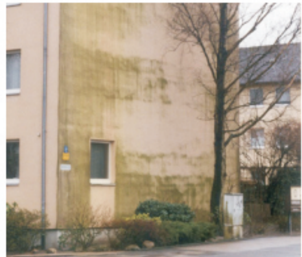
Bild 6.2: Algenbewuchs auf einer Fassade
