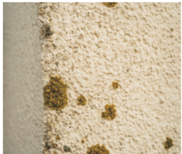
Bild 2: Flechtenbewuchs auf einer Fassade
