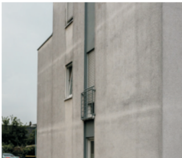
Bild 1: Pilzbewuchs auf einer Fassade
