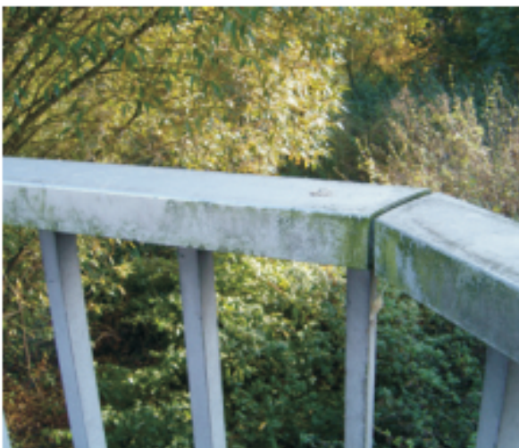
Bild 3: Algenbewuchs auf einem Geländer
