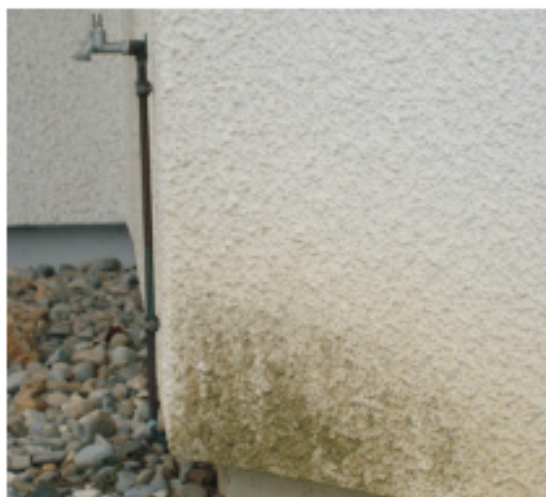
Bild 5.1: Algenbewuchs im Spritzwasserbereich einer Fassade
